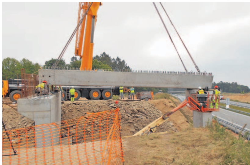
El puente que permitirá el enlace hacia el sur de la AP-9 en Sigüeiro ya está prácticamente ultimado.
